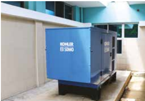
Se han instalado plantas de energía.
