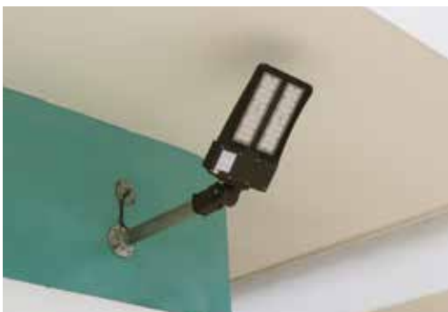
Se han instalado nuevas lámparas LED para una mejor y eficiente iluminación.
